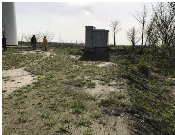
图 2 风机及箱变区
